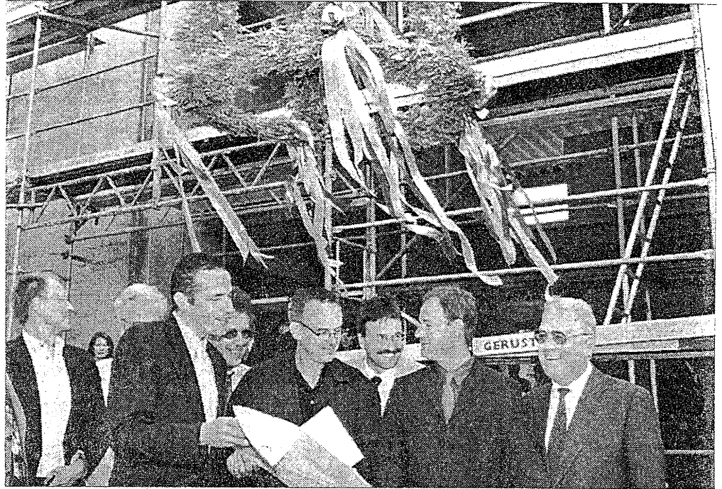
Beim Richtfest waren Vertreter aus Politik, Verwaltung, Wirtschaft zugegen. Ganz rechts: Sparkassenchef Hans Jochims, Mitte: Architekt Rudolph neben Bürgermeister Landscheidt (l.). Foto: Kress
